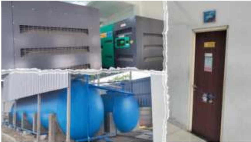
Gambar 2.16 Instalasi Pemeliharaan Sarana Rumah Sakit RSUD Sidoarjo Barat
